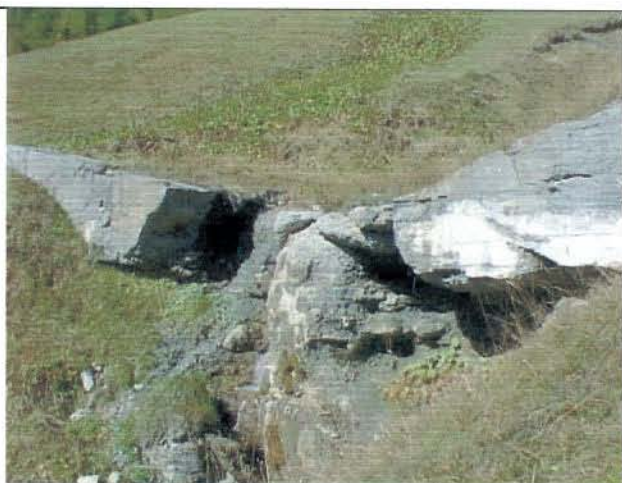
Foto 11 Prima briglia nel tratto costeggiato da prati (si nota la precarietà dell'opera)
